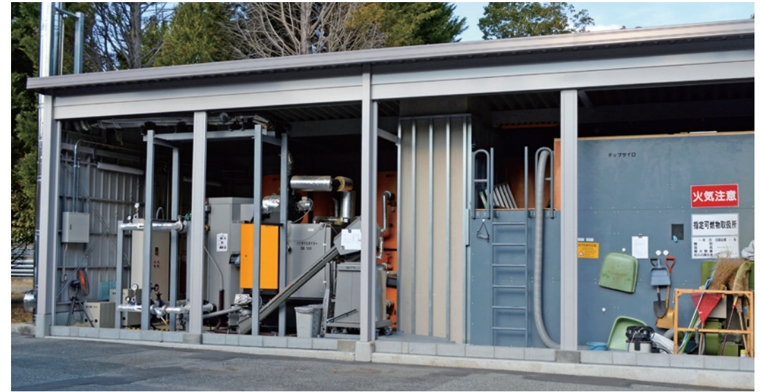
六甲国際GCに設置されているバイオマスボイラー
