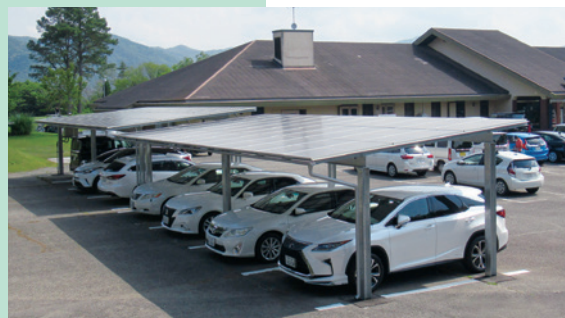
駐車場スペースを有効活用した太陽光発電
