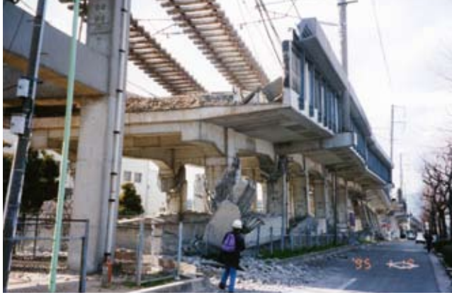
崩れ落ちた高架橋が地震の大きさを物語っている。
